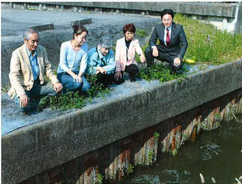
近隣住民の方と包里排水路を視察。鋼がサビ、穴も空き、劣化が激しい。護岸の傾きや周辺道路の陥没も懸念される。
